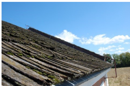
Dach spichlerza przed remontem
